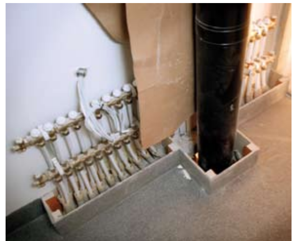
Kuva 8. Vesikiertoisen lattialämmityksen huonekohtaiset lämmitysputket asennettuina jakotukkiin ja suojaputkiin /Tapio Vanhatalo/.
