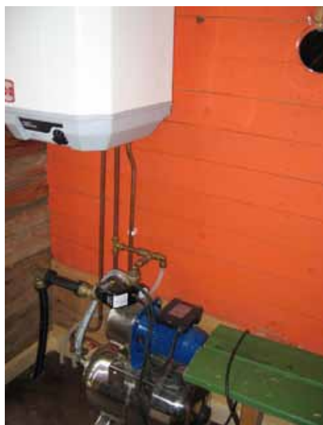
Kuva 29. Kylmissä tiloissa oleva vesipumppu ja lämminvesivaraaja on tyhjennettävä talveksi jotta jäätyvä vesi ei riko laitteita. Kuva: Arja Rytönen, TTS tutkimus.
