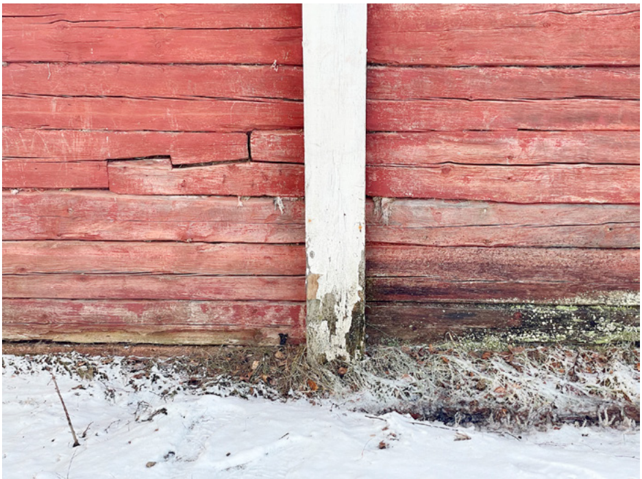
HIRSISEINÄN VAURIOITA POHJATUVAN PUOLEISELLA SEINÄLLÄ. HIRREN JATKOSKOHDASSA VASEM-MALLA ON KÄYTETTY HAMMASLAPALIITOSTA. KUVA JUSSI KALLIOKOSKI.
