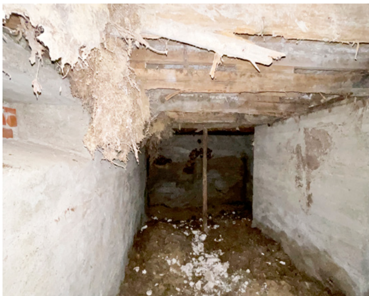
KELLARIN KOSTEUDEN VAURIOITTAMA VÄLIPOHJA. KUVA JUSSI KALLIOKOSKI.
