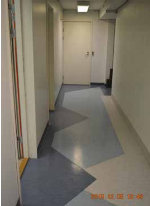
Muovimatointarsiaa kellarikerroksessa. Muovimatot nostettiin monessa tilassa seinälle jalkalistaksi. Kuva Teijo Laaksonen.
