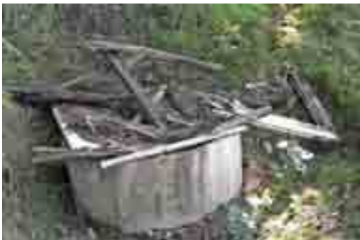
Kuva 114. Rengaskaivon puinen kansirakennelma on lahonnut ja sortunut aiheuttaen vaaratekijän ihmisille ja eläimille. Pintavesien kaivoon pääsyn estävää suojakerrosta ei ole rakennettu tässäkään kaivossa. Pienien eläinten pääsy kaivoon on mahdollista, mikä aiheuttaa kaivoveden likaantumisaaravan. (Kuva: Petri Siiro)
