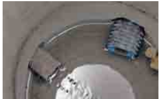
Kuva 95. Jakokaivo sekä siihen tulevan ja siitä lähtevän veden putket. Kuvasta näkyy hyvin jatkuva ylivuotovirtaus, mikä tässä tapauksessa johdetaan lähellä olevaan lampeen.
