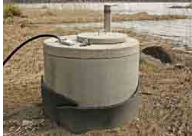
Kuva 97. Rengaskaivo liian lähellä järven ranta. Järven vedenpinnan noustessa keväällä ja syksyllä pintavesi pääsee kulkeutumaan kaivoon ja voi pilata kaivoveden laadun. Jos kaivon yläpuolelta ei ole voimakasta pohjaveden virtausta järveen, kaivoa ympäröivän maanpinnan tulisi olla ainakin pari metriä vesistön tulvarajan yläpuolella. Kaivon ulkopuolinen roustaeristys on keskeneräinen.
