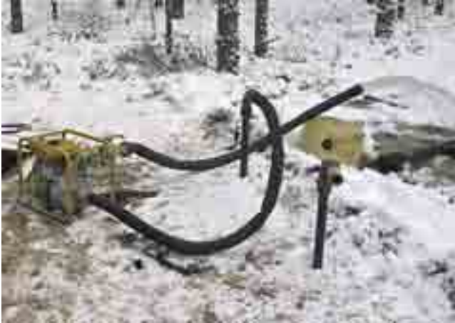
Kuva 54. Pohjavesinäytteen pumpaus 1 1/4":n teräsputkesta. Vettä hyvin johtavasta hiekkakerrostuksesta pumpattaessa pumppausteho on yli 150 l/min, jolloin vesi kirkastuu nopeasti. Kuvan esittämän teräsputken avulla voi olla mahdollista pumpata pohjavettä myös hiekkaisesta, löyhärakenteisesta moreenista [6]. Putket on pienissä tutkimuksissa helppo kuljettaa ja asentaa iskuporakoneella. Vedentuotto mitataan astialla ja sekuntikellolla. Pumpauksen onnistuminen hienoainesmoreenista voi olla vaikeaa. (Kuva: Jorma Hintsa)
