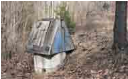
Kuva 112. Huonokuntoinen rengaskaivon kansirakennelma, joka voi aiheuttaa vaaratilanteita esimerkiksi lapsille. Lähellä kasvan puun juuret ulottuvat kaivorenkaiden ympärille ja voivat aiheuttaa renkaiden liikkumista ja vuotokohtien syntymistä. Kaivon ympärille ei ole rakennettu pintavesien pääsyä estävää suojakerrosta. Toisaalta kaivon sijainti on hyvä harjun reunamalla ja pihapiirin ulkopuolella, jolloin pohjaveden likaantumiseriski on pieni.
