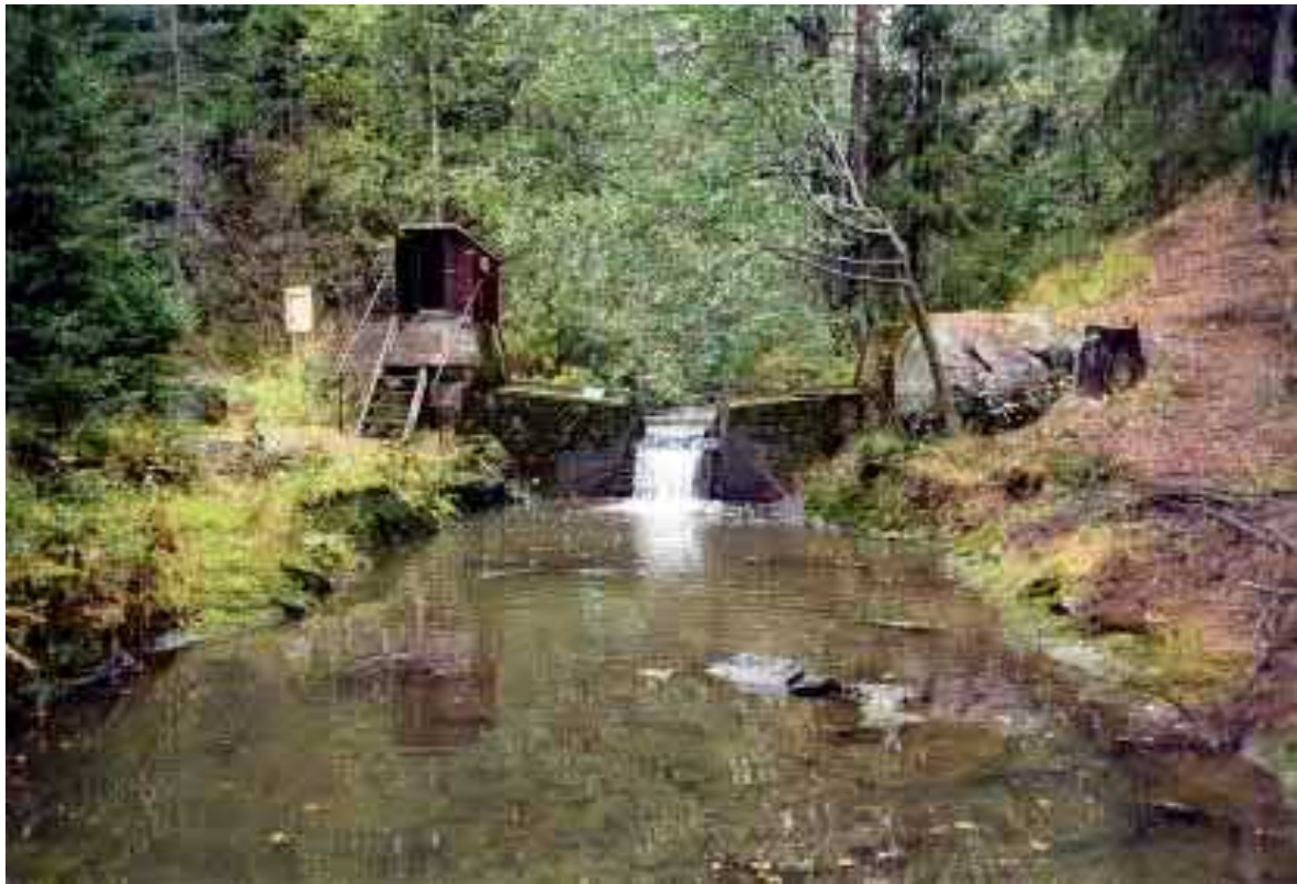
Kuva 2-2. Vuonna 1958 rakennettu Niittyjoen betoninen mittapato lähellä Kouvola. Mittapadon avulla voidaan määrittää virtaama vedenkorkeuseron perusteella. Valuma-alueen ala on 29,7 km 2 ja keskiva- luntaa 0,25 m 3 s -1 . Lähde: Suomen ympäristökeskus (Kuusisto 2008).
