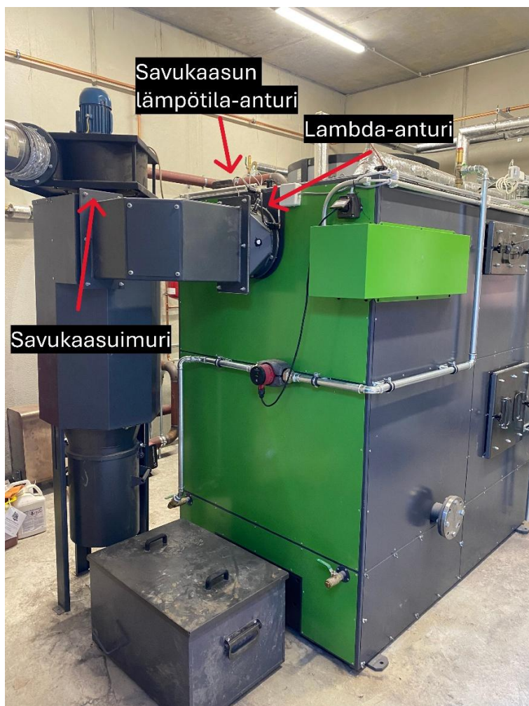
Kuva 6. Lämmityskattilan pääosat takana. (Kuva: Roni Viitala)
