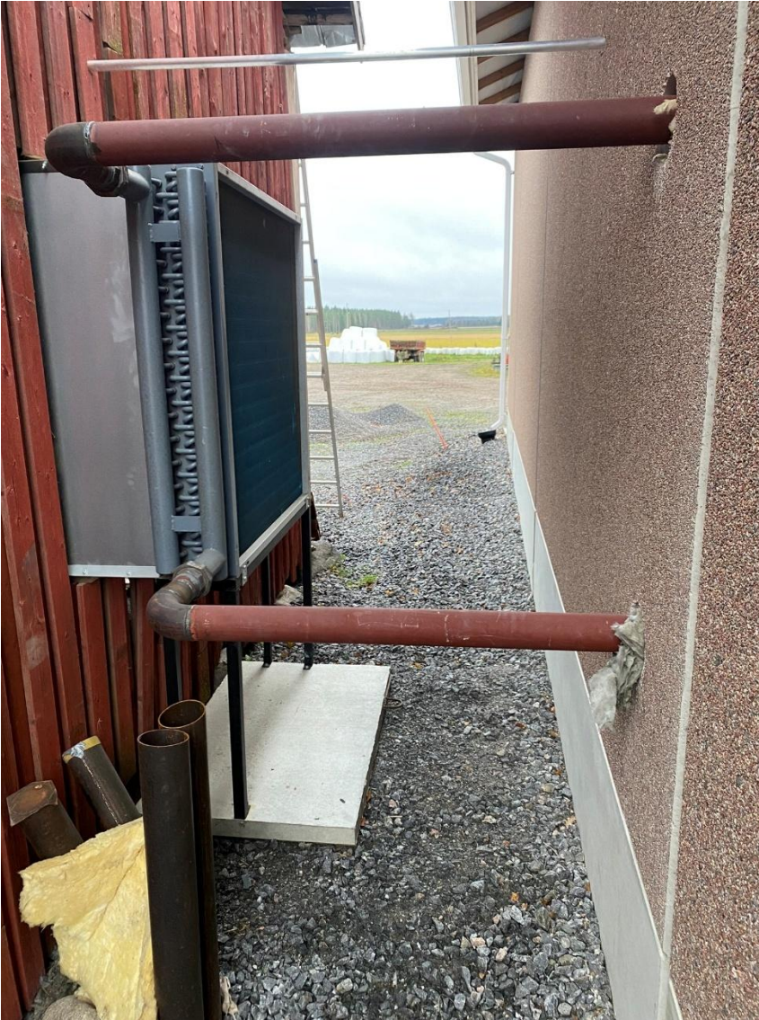
Kuva 1. Vesi-ilma lämmönvaihdin viljankuivurin tuloilma-aukon edessä. (Kuva: Roni Viitala)
